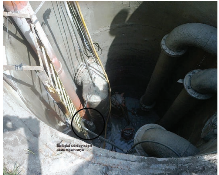
3. kép: Tápszivattyú az üres aknában
