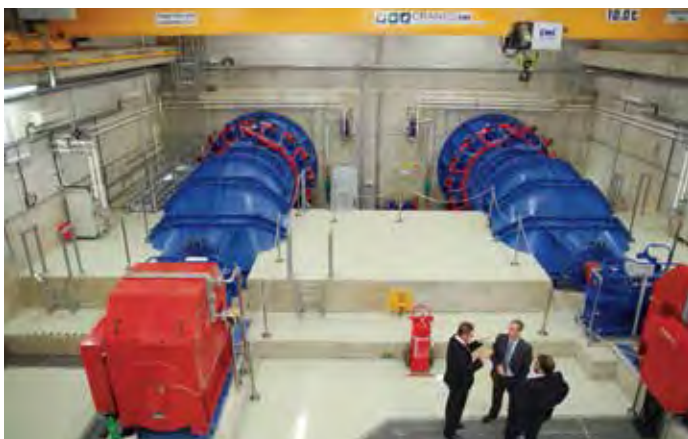
5. ábra – A vízerőmű gépháza az ünnepélyes átadás pillanatában (forrás: NRG Services Kft.)
